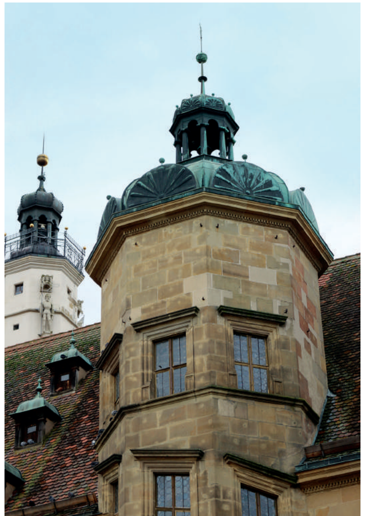
Dank fundierter Fachkenntnisse konnte die patinierte Kupfereindeckung des Rothenburger Rathauses fast vollständig erhalten werden. Das sparte den enormen Energieaufwand ein, der bei der Herstellung des Baumaterials notwendig ist.
